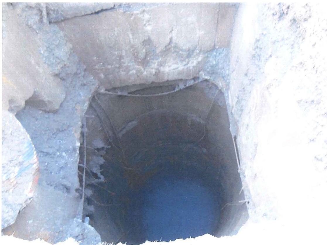
Photo 5 (source : gendarmerie de Lasalle) – Cavité en profondeur
