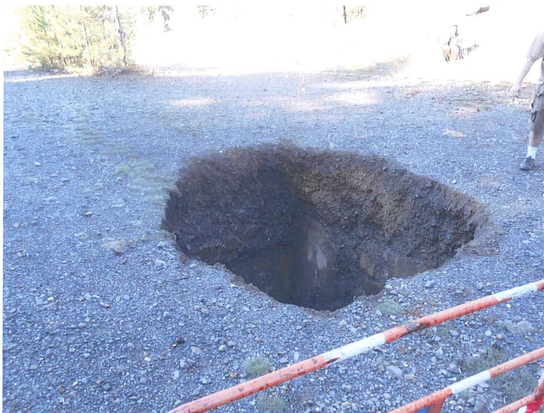
Photo 4 (source : gendarmerie de Lasalle) – Orifice du désordre en surface
