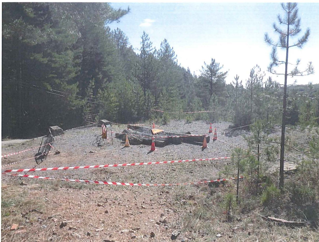
Photo 2 – Désordre d'octobre 2013 sur la commune de Saint-Félix-de-Pallières – mise en sécurité provisoire réalisée par la mairie
